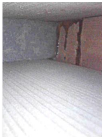
Kannen ja väli­pohjan yhdistävän riman pää pitkällä sivulla lähellä peräsivua.
