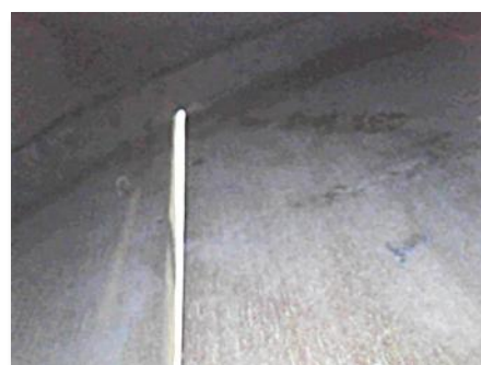
Pohjan halkeama peräsivulla.
